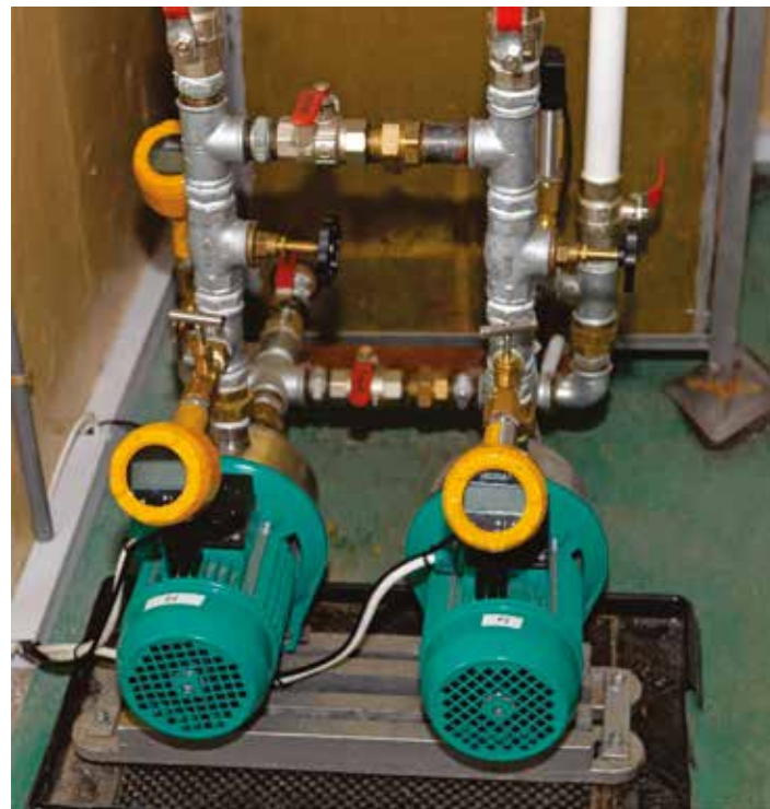
Rys. 2.1. Układ pomp wirowych wraz z zaworami regulacyjnymi, zasuwami oraz przetwornikami ciśnienia na ssaniu i tłoczeniu
