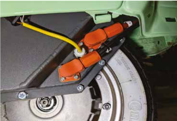
Widok przyłącza silnopiętowego baterii trakcyjnej
