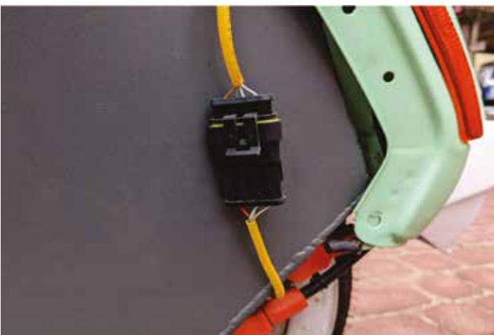
Przewody sygnałowe BMS-a (Battery Management System)
