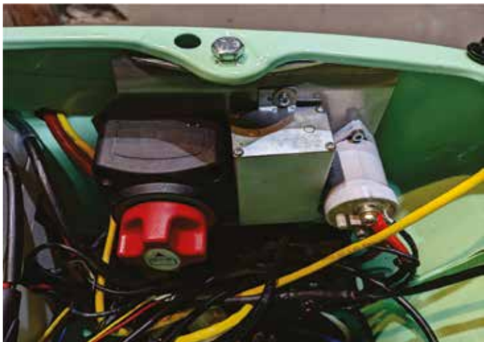
Widok na odłącznik bezpieczeństwa, przetwornicę 48/12 V, stycznik baterii trakcyjnej 48 V
