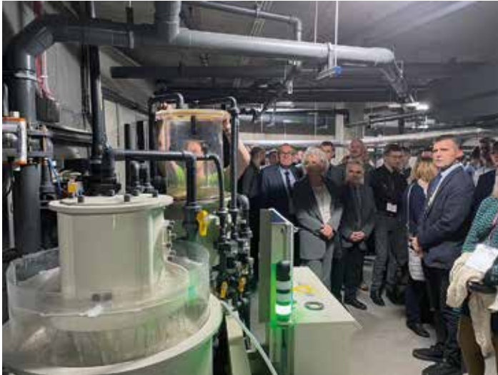
Uczestnicy Konferencji SENE-2022 oglądający infrastrukturę techniczną w podziemiach Orientarium (fot. Jarosław Kacerka)
